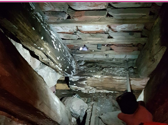
Feuchte Dachsparren Foto: Markt Sulzbach
