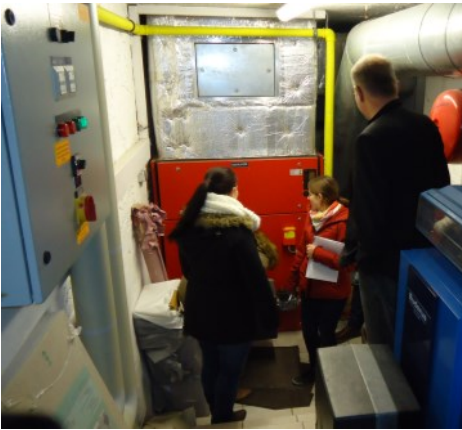
Christina Klein, Katrin Vierheilig und Prof. Meier-Wiechert werfen einen ersten Blick auf die Heizung der Margaretenkirche.
